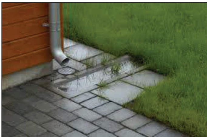
Figur 10. Stuprörsutkastare med avledning till gräsyta (Bollebygds kommun, 2016).
