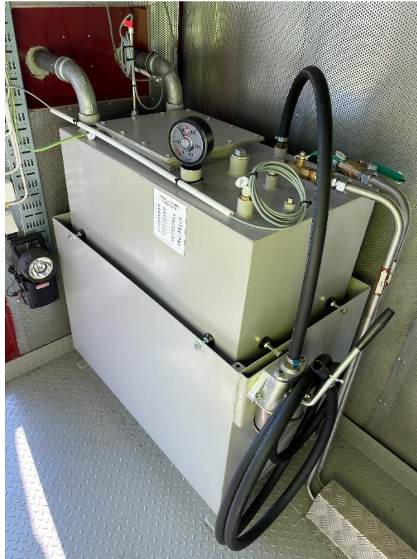
Dieseltanken inuti byggnad för reservkraftaggregat
