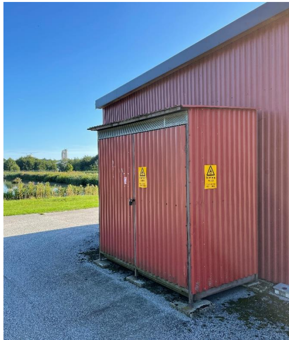
Skåp för brandfarliga vätskor (observera att skylten är felaktig)
