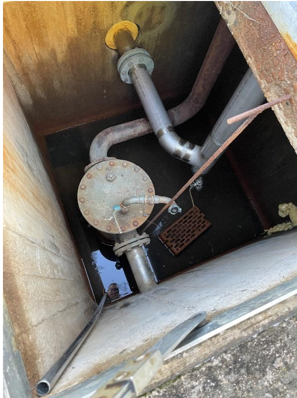
Äldre och nyare gasledningar i brunn vid gasklocka
