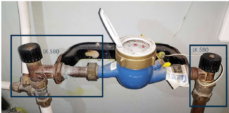
Bild på äldre ventil, LK580. Denna måste bytas ut innan ett vattenmätarbyte kan utföras. Bild från Stockholm Vatten och Avfall.
